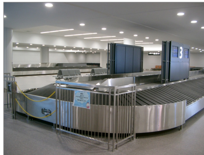
空港手荷物搬送設備
